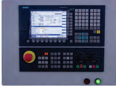
Panneau de contrôle (Siemens)
